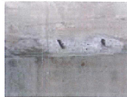
床版 鉄筋露出
