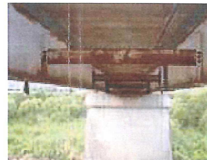
主桁、横桁 さび
