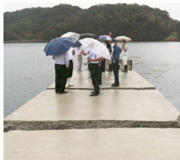
三越防波堤災害状況調査
